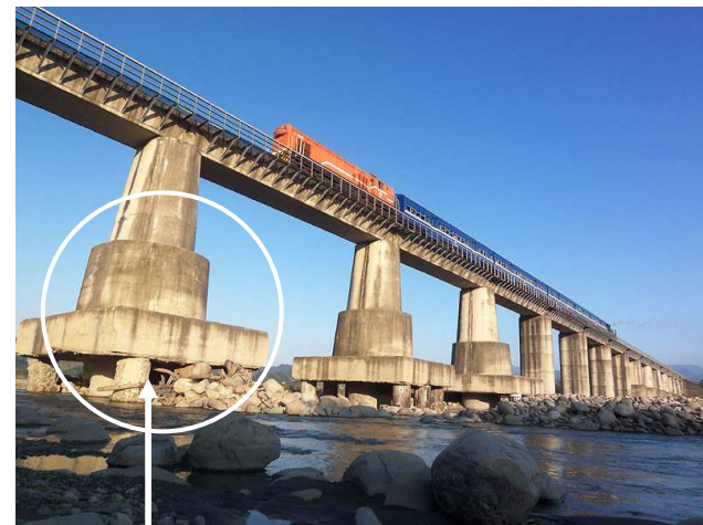
原本應該埋在土裡做為地基的橋墩，已經完全露出地表。
